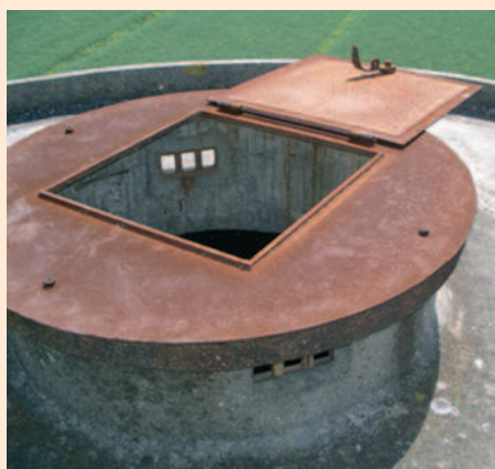
COUVERTURE SANS GARDE-CORPS, CAPOT DÉGRADÉ
